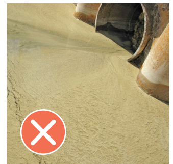
Schlammraum ist überfüllt, Leerung notwendig
