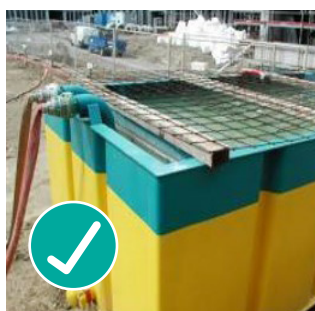
Absetzbecken mit Gitterrost, Einleitung vor der Prallwand/Tauchwand
